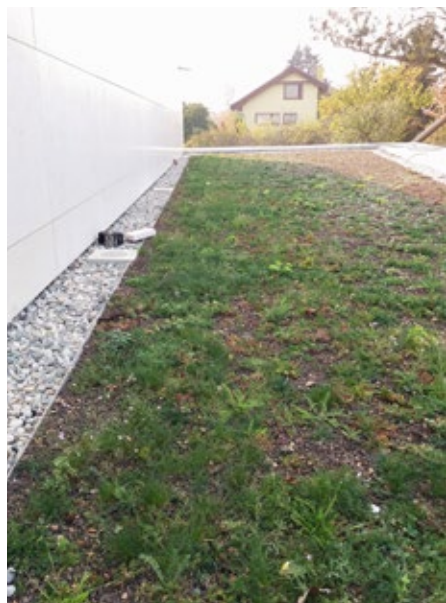
1) Rozdíl mezi osluněnou a zastíněnou plochou
