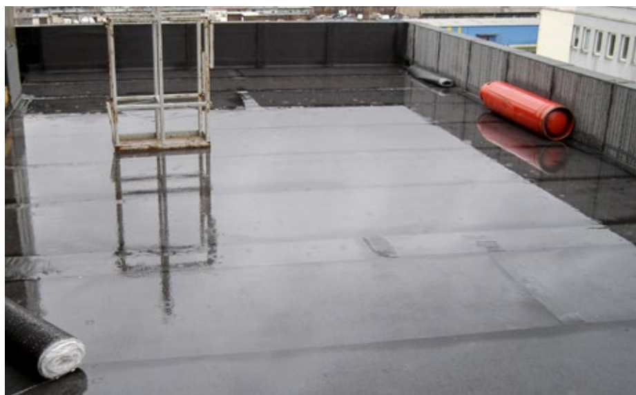
2) Voda na parozábraně, natavené na vodorovné železobetonové konstrukci
