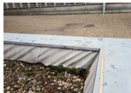
5) PVC hydroizolace časem ztrácí hmotu, ztenčují se a smršťují
