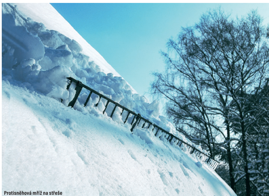
Protisněhová mříž na střeše
