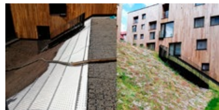
Obr. 4 Příklad šikmé střechy se sklonem nad 15° během realizace a po dokončení (zdroj. Roagrotex s.r.o.)
