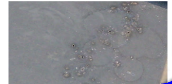
Vnější projev přítomnosti koroze na rubové straně Titanzinkovém plechu.
