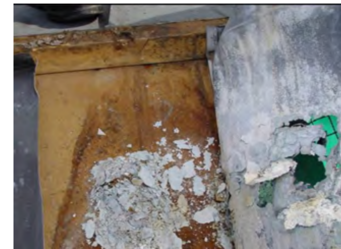
Koroze Titanzinku - zatékání pod klempířskou konstrukcí
